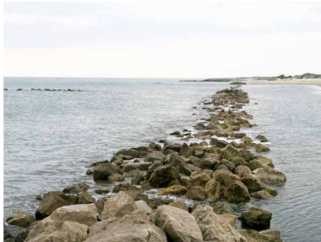
Détérioration de la digue à la mer
